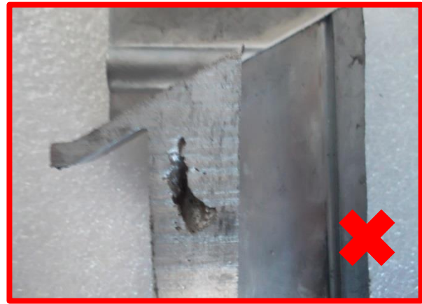
Lunker in Randlage und Tiefe >2mm
