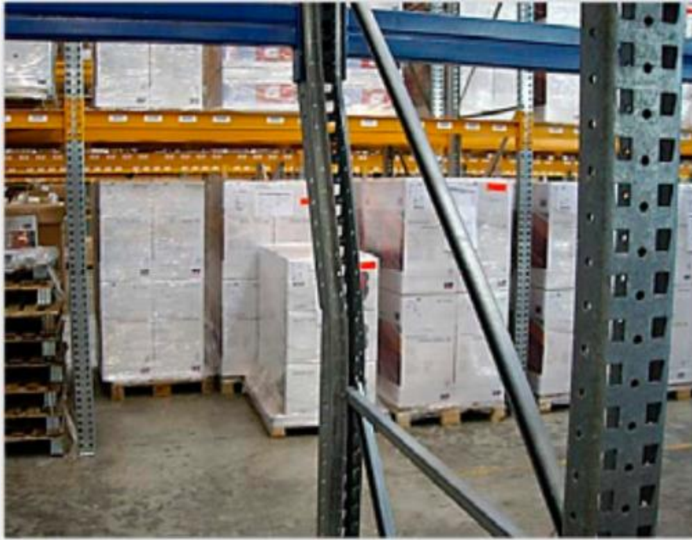
Zusammenprall mit einem Flurförderfahrzeug: Regalständer ist stark beschädigt.
