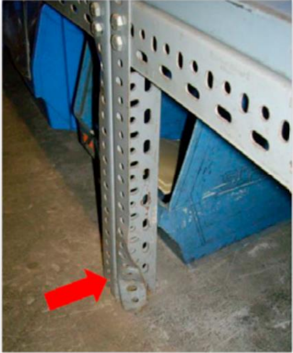
Fachbodenregalständer: Beschädigung durch Gabelhubwagen
