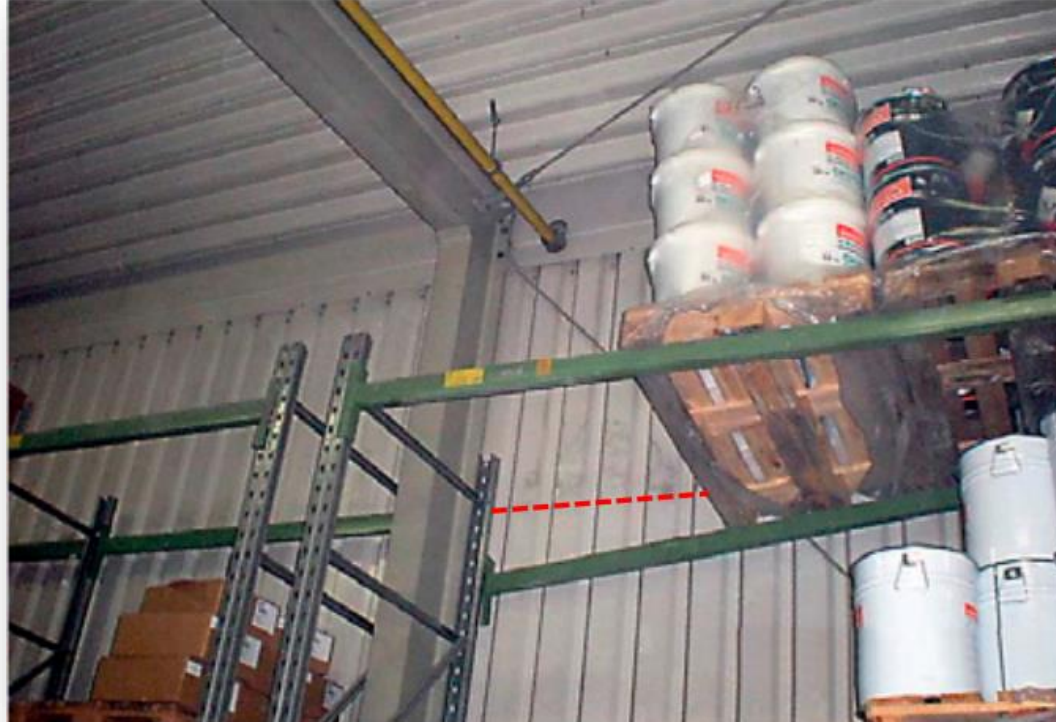
Nicht gegen Aushängen gesicherte Traverse Ergebnis: ausgehängt - Gefahr!
